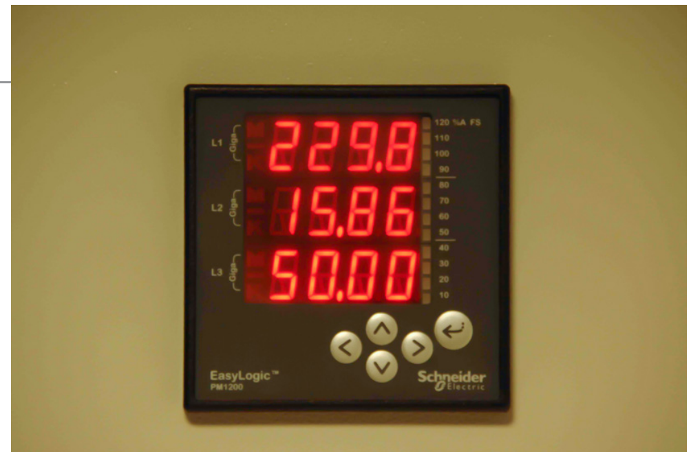
► تجهیزات تابلو برق اشنایدر فرانسه
